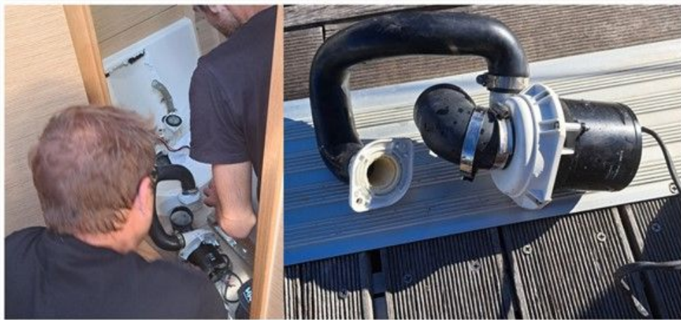
Trotz Demontage des Spülmotors und Reinigung funktionierte unser WC immer noch nicht!
