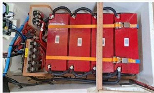
Trotz neuer Batterien müssen wir nach 3 Tagen Ankern in der Marina nachladen.
