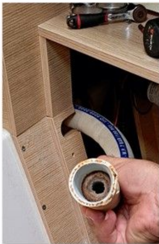
Durch diese Schläuche geht nichts mehr durch!
