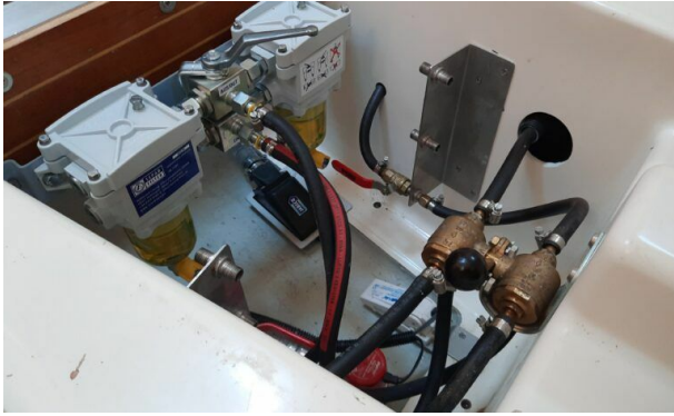
Unsere neue Diesel-Doppelfilteranlage zur Vermeidung von Motorausfällen.
